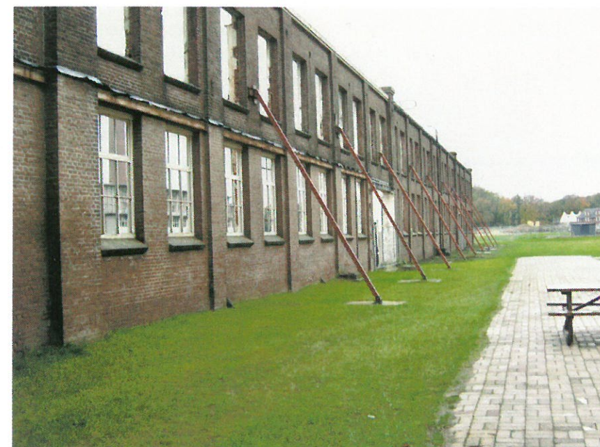
Alleen de muren staan er nog.
