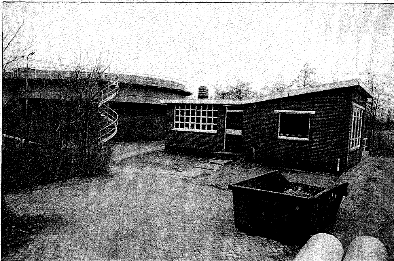
Foto 8: De Clarigester in Wormer werd in 1971 in bedrijf gesteld. Rechts in het gebouw bevindt zich het opvoerge-maal, de elektrische schakelkast en het snijrooster (Hubert) (Foto: N. Groeneveld).
