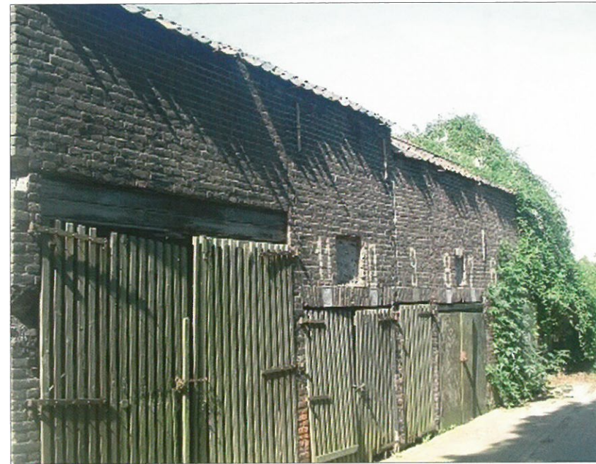
Kampen wil deze palingsrookerij (foto's links en rechts) afbreken en elders herbouwen. Foto Marcel Overbeek
